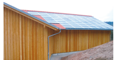
Photovoltaikanlage auf Dach
