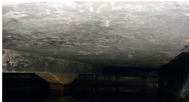
Stark beschädigter Behälter
