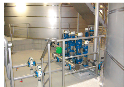
Installation mit Druckerhöhungsanlage
