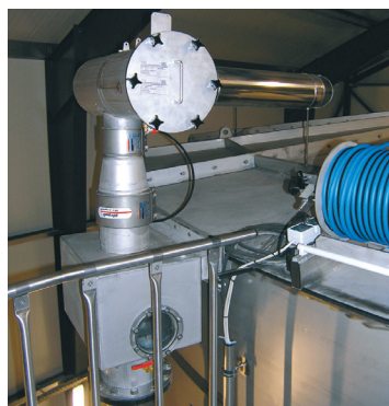
Überlauf und Luftfilteranlage
