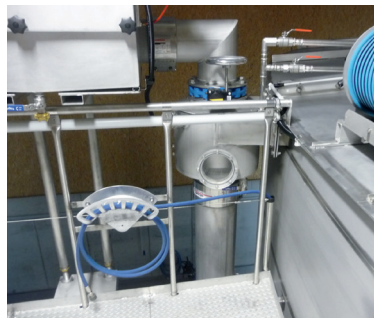
Überlauf mit Siphon
