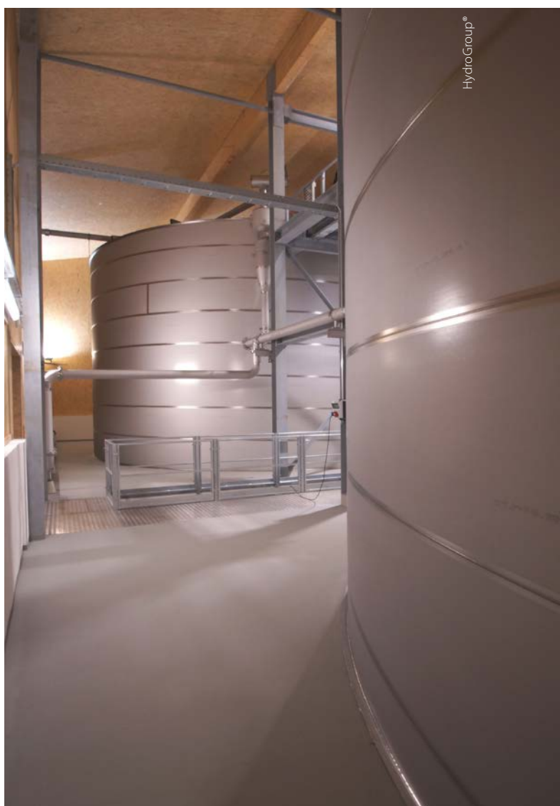
Bild 6: Edelstahlbehälteranlage 2 x 500 m 3
