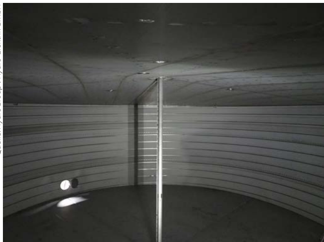
Bild 3: Innenansicht der Edelstahlbehälter mit Mittelsäule
