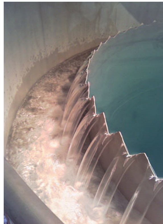
Abb. 4 Klarwasserüberlauf im Reaktorauslauf
