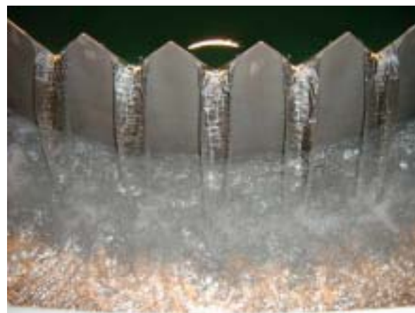
Bild 3. Der Klarwasserüberlauf im Reaktorauslauf.
