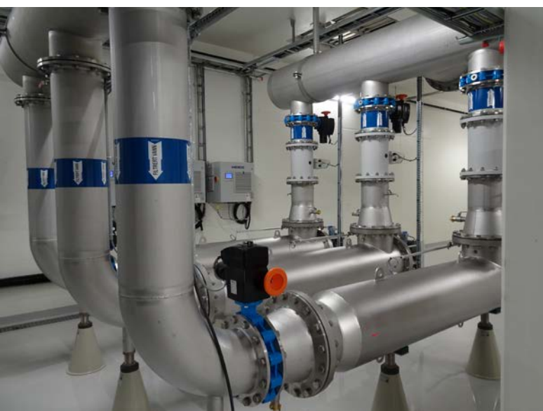
Bild 6: UV-Anlagen zur betriebsabschließenden Desinfektion
