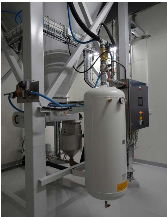
Bild 5: Kalk-Silo mit Steuerung und Wasserstrahlpumpe
