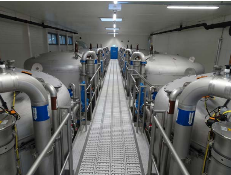
Bild 4: Obere Bedienebene der zehn Filteranlagen
